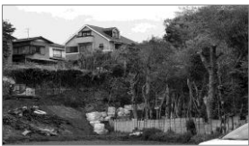
隣接傾斜地に配慮を欠くマンション工事で危険。
