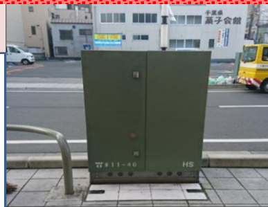
50M~100M に一つ冷蔵庫程の電盤を置き電線を地中化する
